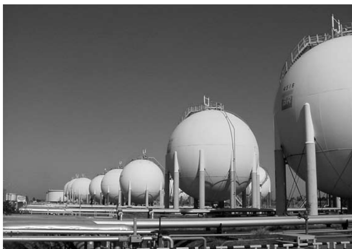
FIGURA 15 - Esferas e dutovias área de tancagem da REPLAN
