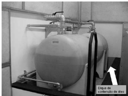
FIGURA 2: Outros detalhes do leiaute da sala do gerador – dique de contenção de óleo / tratamento acústico nas paredes
