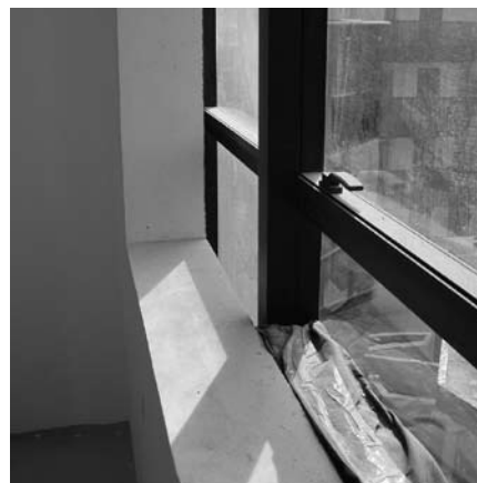
FIGURA 9: Proteção do espaço entre a estrutura da edificação e a pele de vidro
