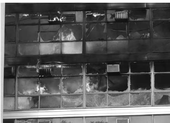
FIGURA 2: Ausência de compartimentação vertical
